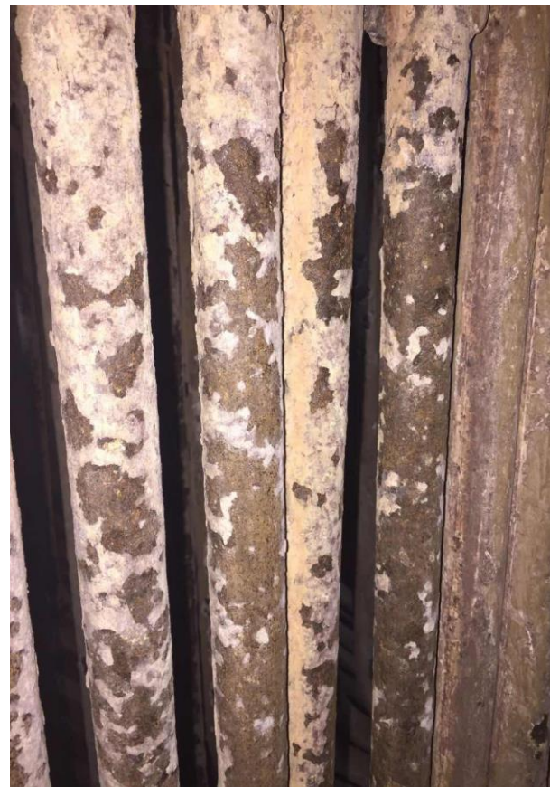
水管腐食減肉
